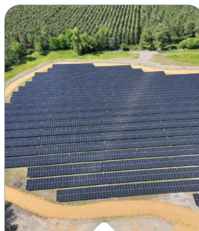
Centrales au sol
